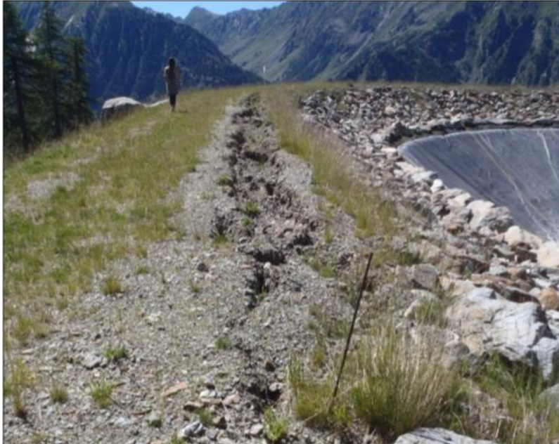
Fissure en tête de talus (photo M.Boutry, projet RISBA) Crepa in cima al pendio (Foto M.Boutry, projet RISBA)
