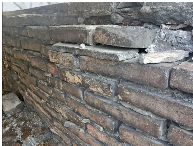
3. Una parte della scena in cui il cemento slegato dai mattoni favorisce il rischio di crollo della struttura. (P. Bancod)
