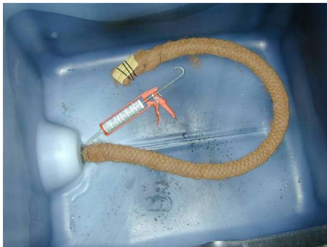
Figura 37: Tubo di drenaggio posto sul fondo di una unità di bio depurazione.
