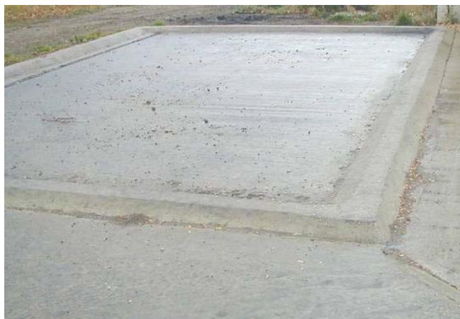
Figura 25: Esempio di area pavimentata per il riempimento ed il lavaggio delle attrezzature in grado di convogliare le acque contaminate da agrofarmaci ai sistemi di depurazione attraverso un canale in cemento (foto: DAAS).
