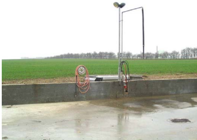
Figura 24: Area attrezzata e pavimentata per le operazioni di riempimento e lavaggio dell'irroratrice, dotata di sistema di raccolta per convogliare le acque contaminate al sistema di bio depurazione (foto: DAAS).
