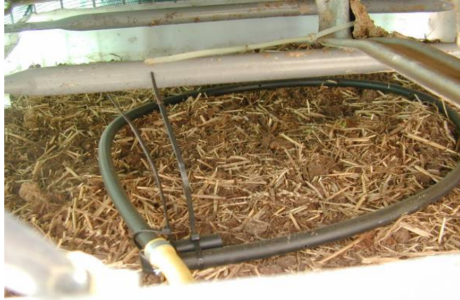
Figura 31: Distribuzione del liquido contaminato sulla superficie filtrante attraverso un tubo circolare perforato (foto: pcfruit).
