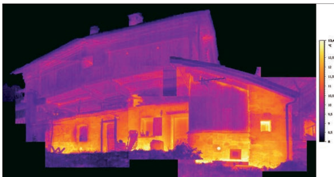
4. Mosaico di termografie con il software Grayess Stitch. L'acquisizione dei termogrammi è del giorno 11/09/2015. Non si riscontra particolare differenza tra le parti di muratura in ambienti non riscaldati (sinistra) e quelle riscaldate (destra).
