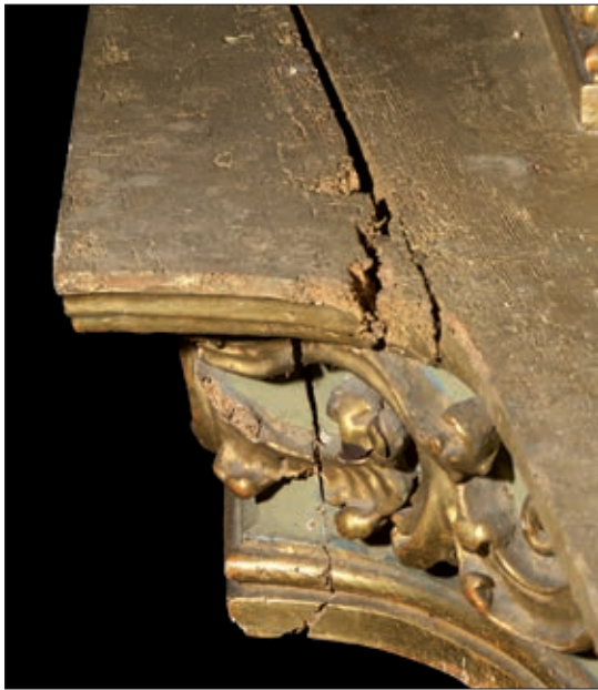
4. Altare maggiore. Lesioni di supporto nei gradini della predella superiore alla mensa. (Pm. Reboulaz)
