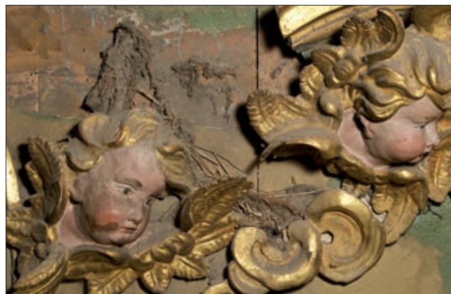
3. Altare maggiore. Depositi di polvere e materiale organico riscontrato sul frontone. (Pm. Reboulaz)
