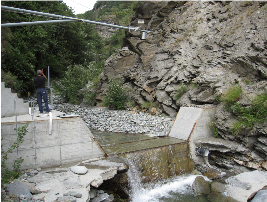
Foto 1: Vista da valle verso monte della stazione idrometrica
