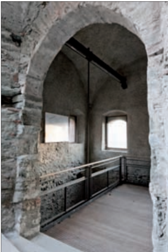
3. Rivellino, particolare dell'arco d'accesso al percorso di visita e della passerella sospesa. (P. Celesia)
