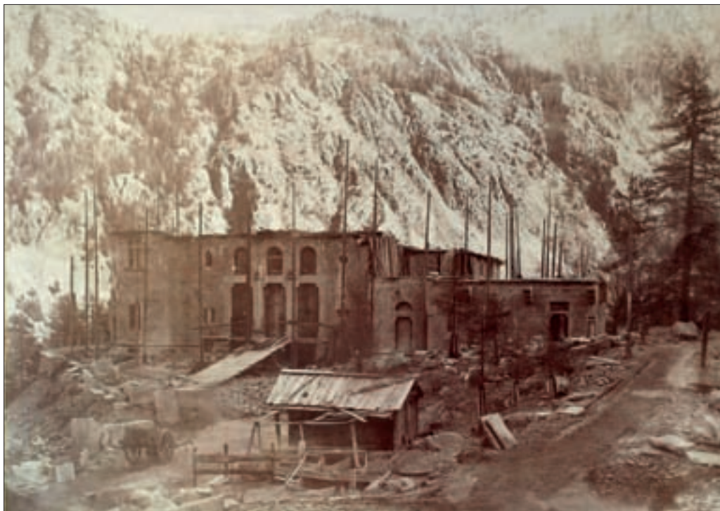
3. Stato di avanzamento del cantiere di Castel Savoia, veduta da sud-ovest, III trimestre 1901. (Archivio Eredi Stramucchi)
