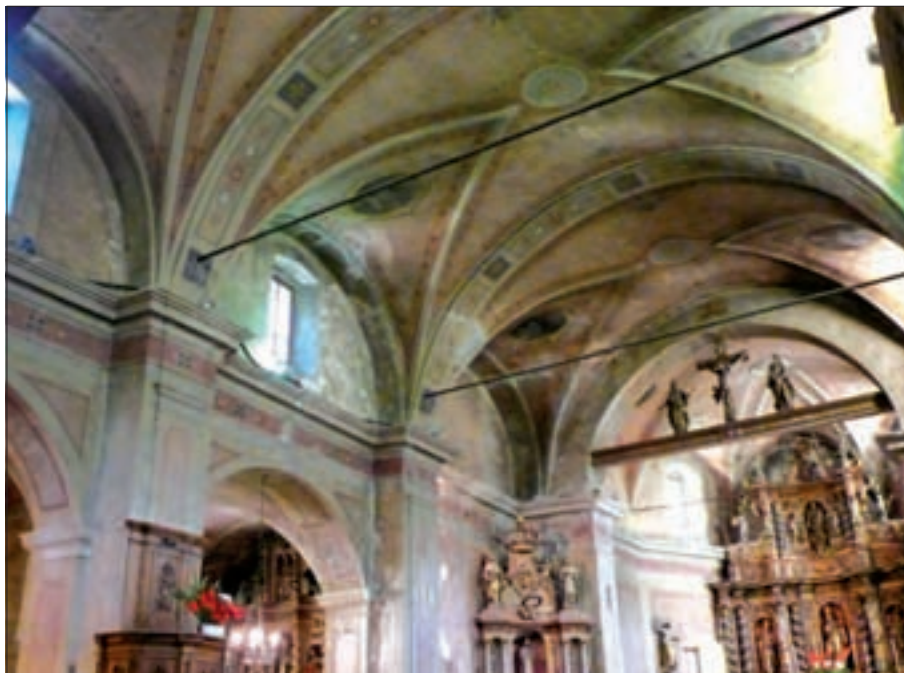
6. Superfici interne degradate prima degli interventi. (D. Costantini)
