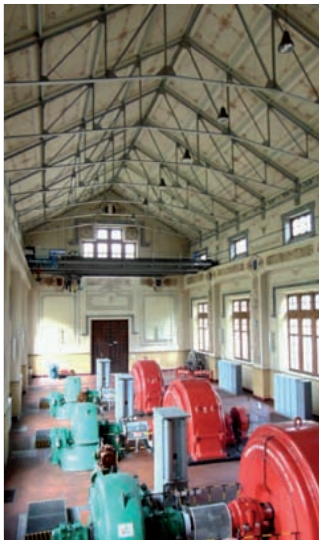
7. La sala macchine illuminata attraverso le ampie finestrate. (C.F. Quiriconi).
