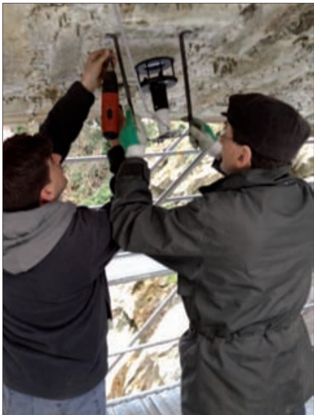
7. Installazione di anemometro sonico a Le Pont-d'Ael. (S. Migliorini)
