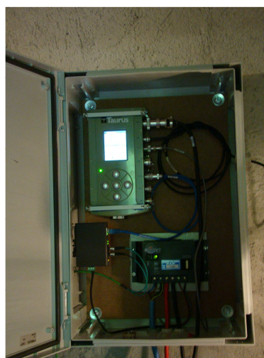
Station sismique ENR - Armoire électronique
