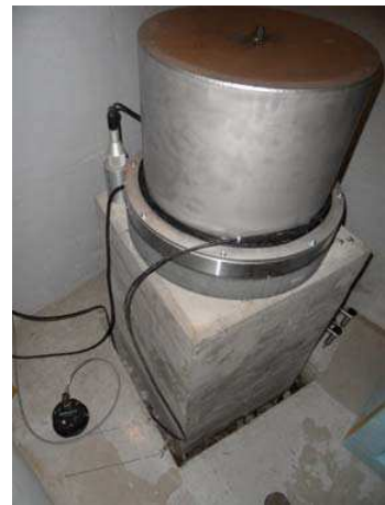
Capteur recouvert par sa cloche en acier inox
