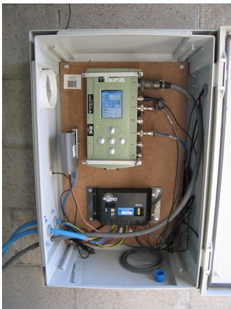
Station sismique ROTM – Armoire électronique
