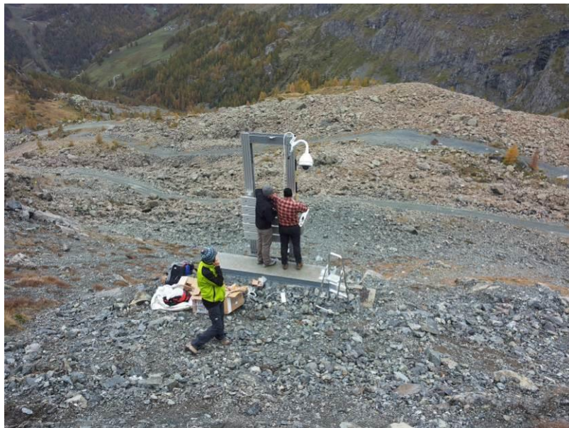
Installation de la web cam et entretien du système obstacle
