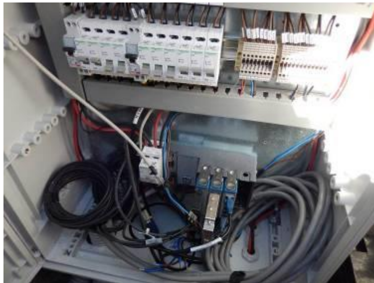
Logement des systèmes d'acquisition et transmission des données
