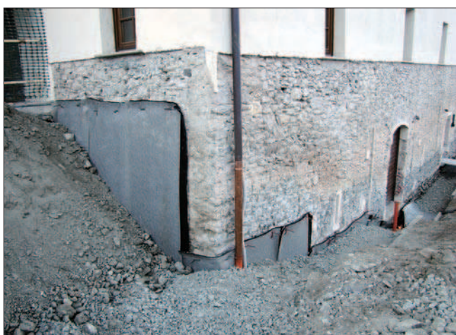
3. L'angle Nord-Est de la grandze pendant les travaux d'imperméabilisation et de réfection de l'enduit. (A. Novel)
