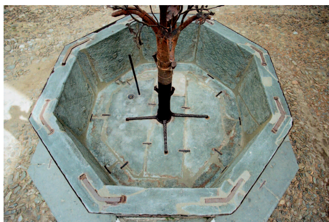
5. Interno della vasca e bordo, al termine dell'intervento di restauro. (G. Di Carlo)
