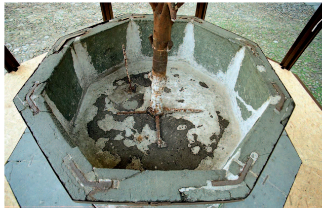
2. Interno della vasca prima del restauro. Il fondo e i giunti dei componenti della vasca sono completamente ricoperti da strati di cemento bianco-grigiastro sui quali è visibile il residuo dell'ultimo rivestimento bituminoso nero. Inoltre, si noti la pronunciata ossidazione sul fusto in ferro del melograno e le incrostazioni calcaree bianche che in parte lo rivestono. (G. Di Carlo)
