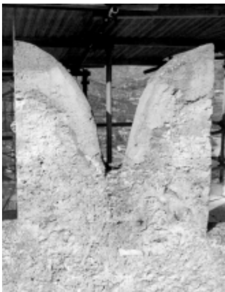
Merlo 07 I della torre nord-est prima dell'intervento di asportazione delle parti in cemento. (A. Novel)
