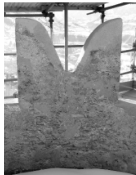
Merlo 07 I della torre nord-est dopo l'intervento di sostituzione con malta di calce. (A. Novel)
