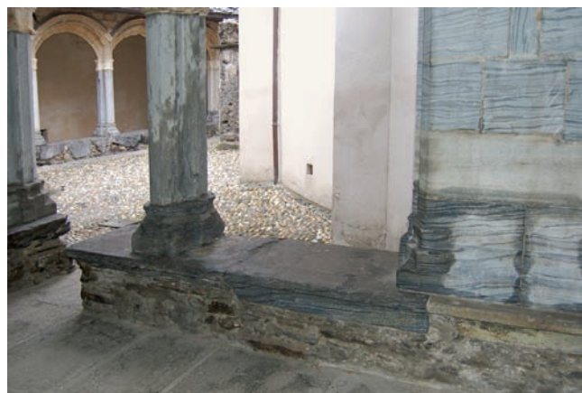
2. Particolare della risalita di umidità sul muretto e le colonnine in bardiglio. (A. Novel)
