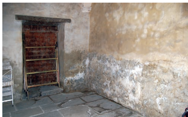
4. Particolare del degrado visibile sul muro nord-ovest. (A. Novel)
