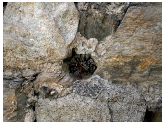
37. Torre ovest del castello di Saint-Pierre, travicello tagliato a filo della muratura. (E. Calcagno)
