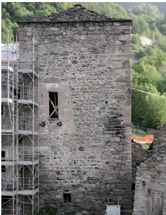
29. Tour Nèran a Châtillon da sud, 2008. (M. Cortelazzo)
