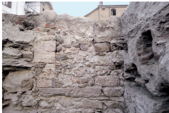
21. Apertura tamponata in una delle pareti dei vani cantinati di Maison Chappuis. (M. Cortelazzo)
