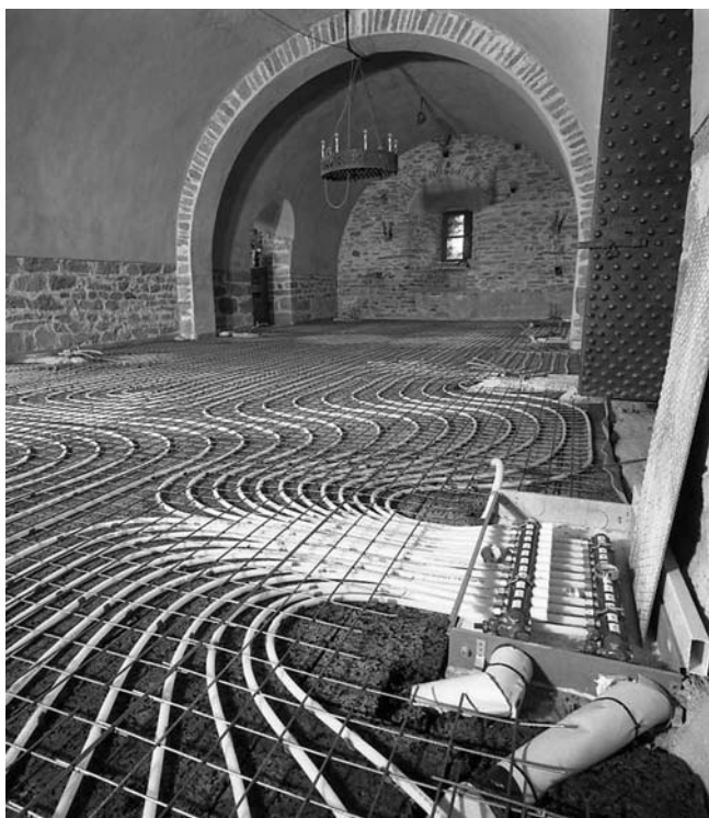
7. Il riscaldamento a pavimento di alcune sale: particolare del collettore. (D. Cesare)
