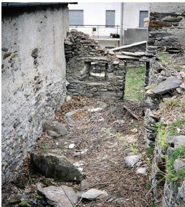
11. - 12. Il locale dunà , prima e dopo l'intervento di risanamento e ripristino. (F. Pizzini)
