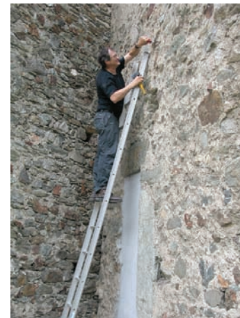
9. Torrione, parete esterna nord, prelievo di un trave delle impalcature per la ricostruzione del 1261. (M. Cortelazzo)
