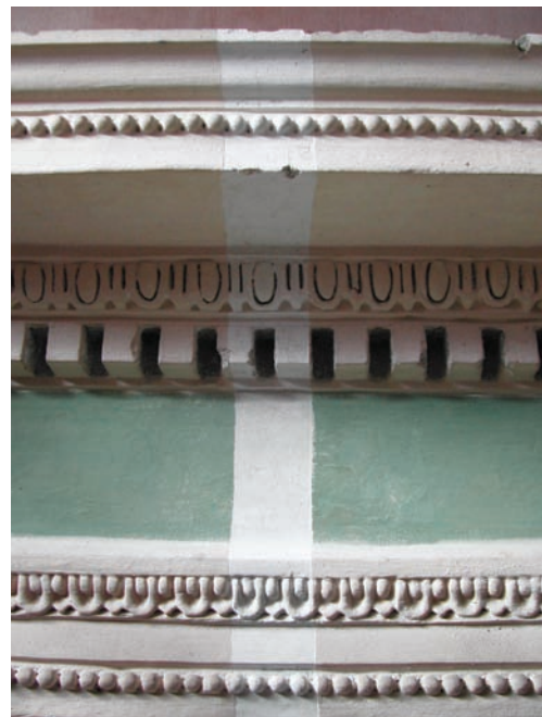
59. Parete in controfacciata, tassello con asportazione delle ridipinture. (P. Fioravanti)
