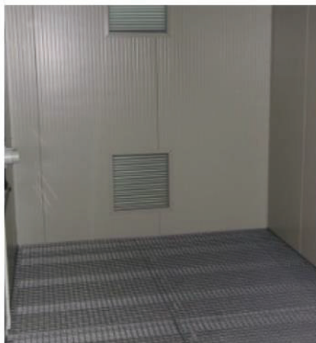
Particolare pavimento in grigliato per deposito rifiuti liquidi
