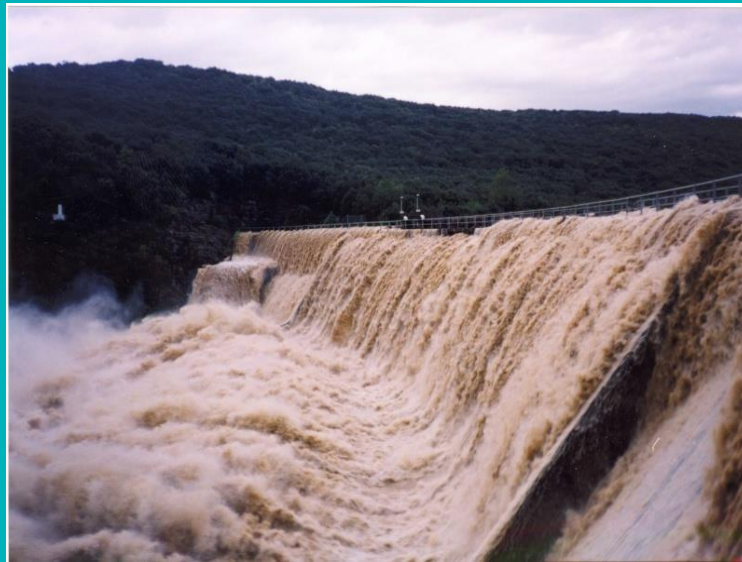
Surverse par-dessus le barrage due à une crue Straripamento della diga a causa di un'inondazione
